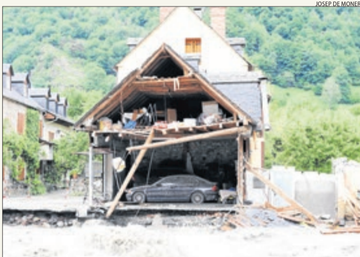
Una casa amb la façana demolida a Bossòst per la riuada del 2013.
